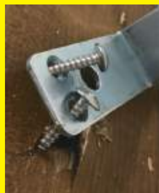
書架天板固定部破損
